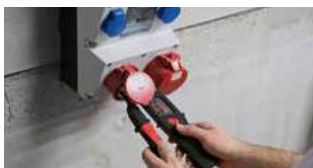
Prova tensione su prese CEE
